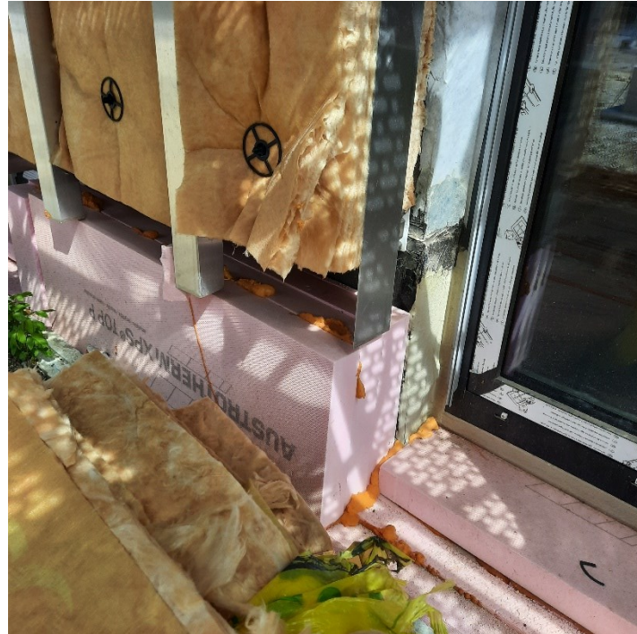
Abbildung 8: Fassadenaufbau mit hohem Kunststoffanteil: u. a. XPS-Dämmung im Sockelbereich, PU-Schaum, Mineralwolle mit kunststoffhaltigem Bindemittel als Fassadendämmung, Kunststoffhalter zur Befestigung von der Dämmung (Bild: IBO GmbH)
