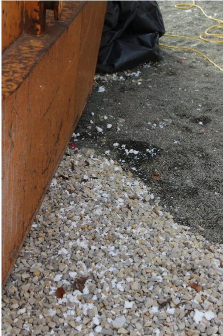
Abbildung 11: Freisetzung von Mikro- und Makroplastik beim Rückbau von Polystyrol-Dämmplatten (Bild: Hochschule München)
