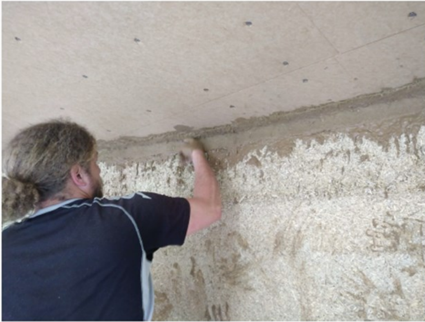
Abbildung 6: Applikation von Lehm mit eingeschlammtem Vlies zur Herstellung einer luftdichten Ebene im „Wurzelhaus Allgäu“ (Bild: Michael Sedlmeier, architekturei)
